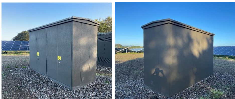
Figur 3.16 – Et eksempel på en sekundær koblingsstationer (til højre og venstre).
