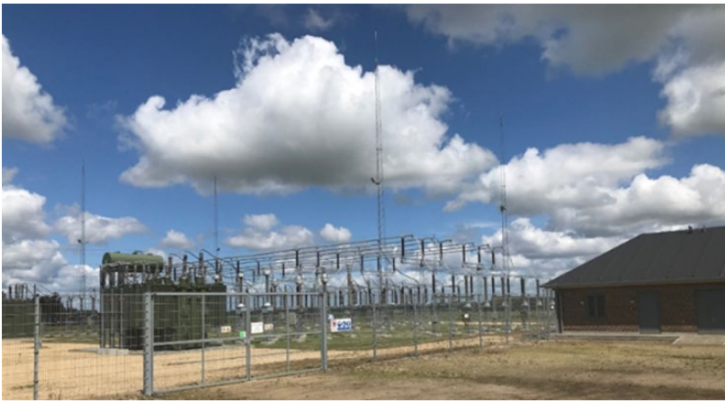
Figur 3: Eksempel på transformerstation med udendørsanlæg.
