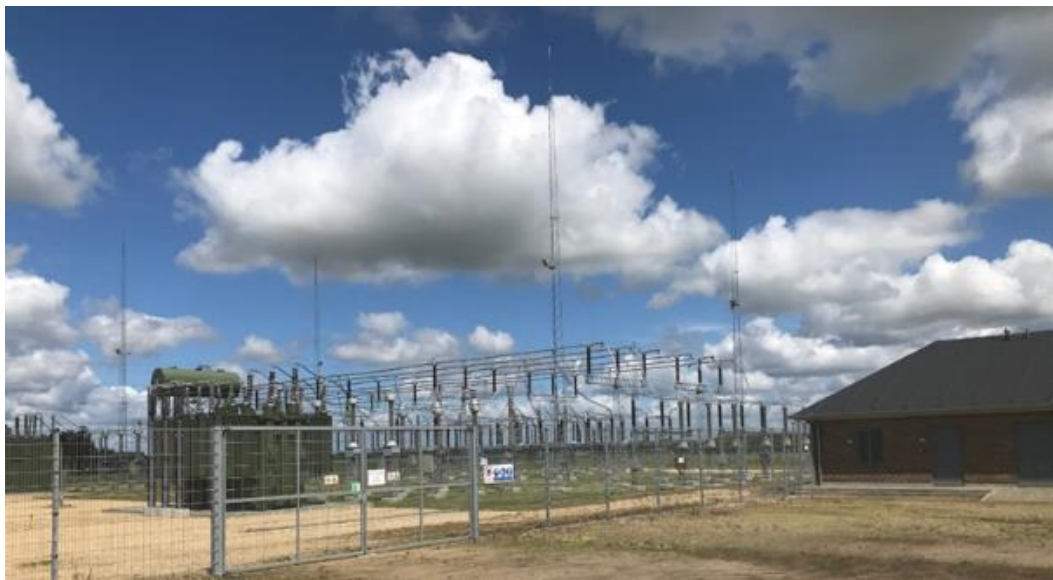
Figur 3.20: Eksempel på transformerstation.
