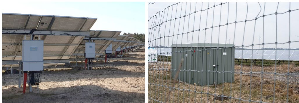
Figur 2: De hvide kasser under solcellerne er invertere, som omdanner jævnstrømmen til vekselstrøm (til venstre). Eksempel på en teknikbygning, her en typisk fordelingstransformer (til højre).
