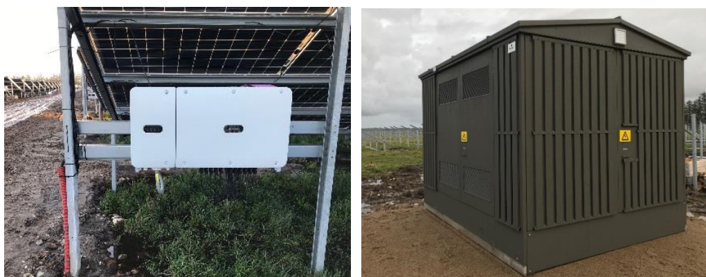
Figur 3.15 – De hvide kasser under solcellerne er invertere, som omdanner jævnstrømmen til vekselstrøm (til venstre) og eksempel på teknikbygning, her en typisk fordelingstransformer (til højre).
