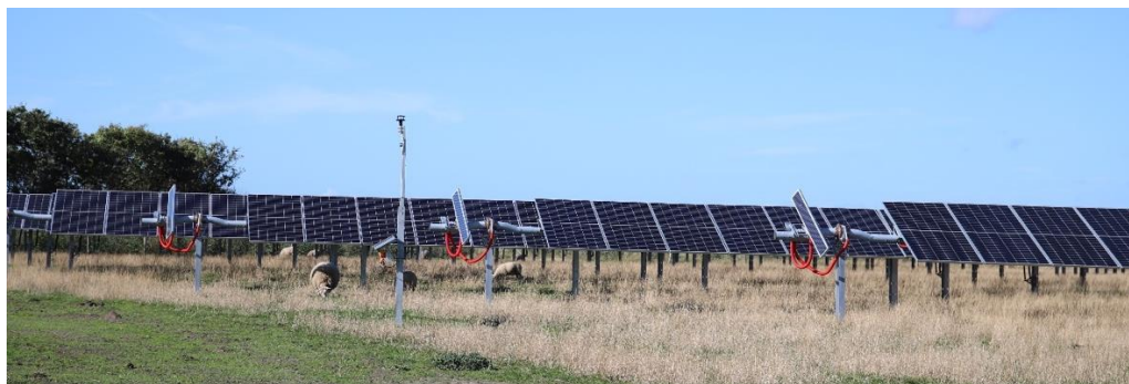
Figur 3.7 – Solceller på trackerstativer med vindmåler.
